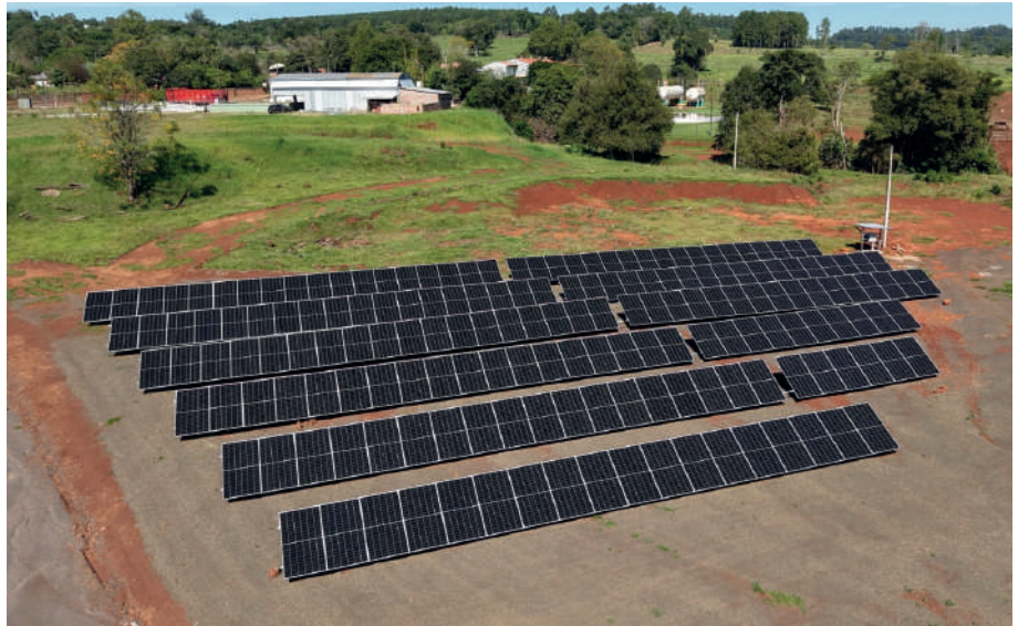
Subidos a la onda sustentable, Miscoopgas apostó por autogenerarse electricidad con una usina solar de 176 paneles. "Nos optimiza el gasto y hasta nos generará un excedente para volcarlo a la red", señaló Omar Cabral.
